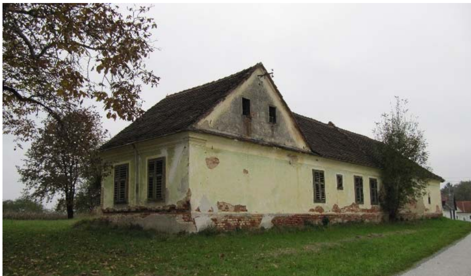
Abbildung 31 Eines von vielen renovierungsbedürftigen Bauernhäusern in einer Bergsiedlung im Südburgenland gelegen (Eigene Aufnahme, November 2015)
