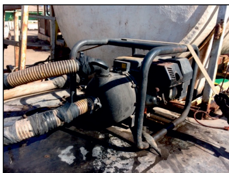
Abb. 42: Wasserlieferung eines Camión Aljibe in einem Campamento : Mithilfe einer Motorpumpe wird Wasser aus dem Tankwagen in einen bereits mehrfach geflickten Plastikschlauch gepumpt (Foto: BAYER, März 2018)
